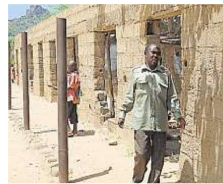
Mit Mitarbeitern der Schule inspizierte Hanns-Peter Kirchmann den Zustand des Gebäudes.
